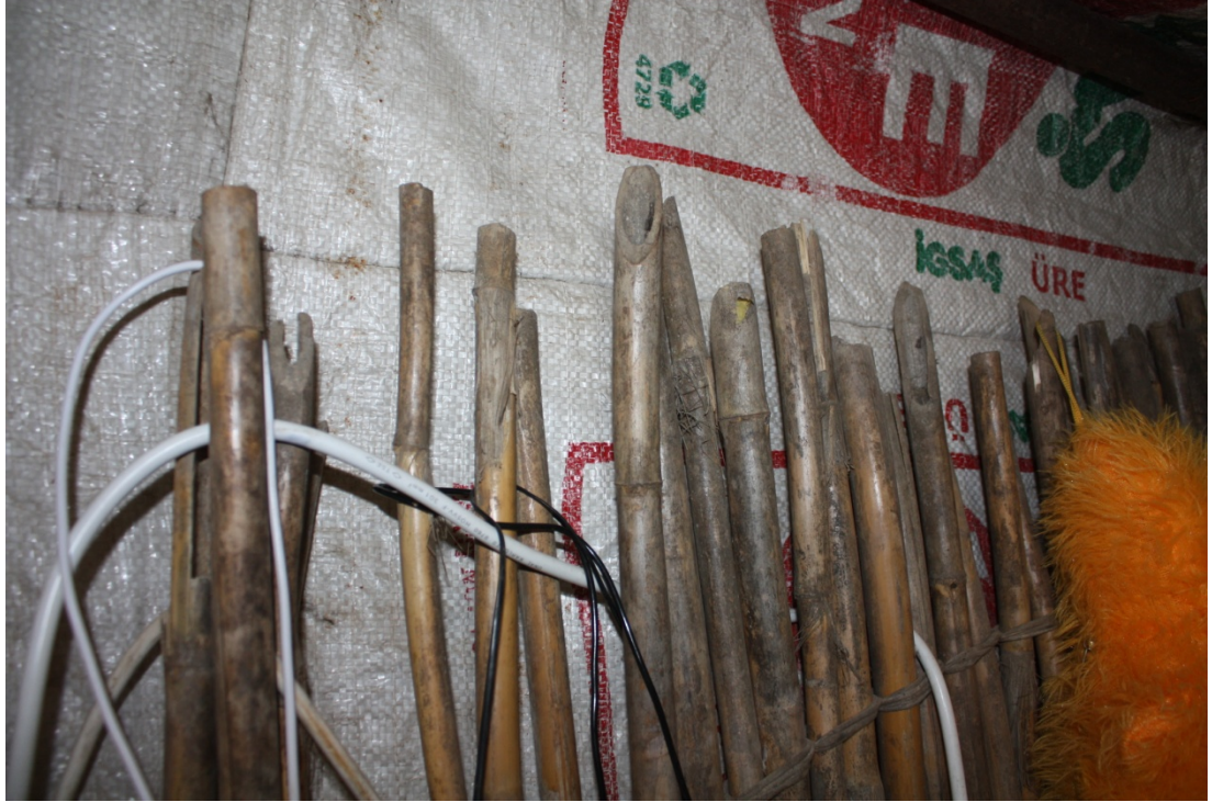
(Ek 3.3 – b): elektrik kabloları
