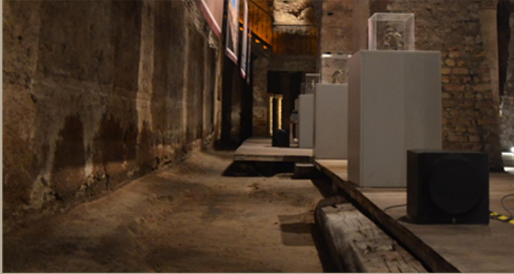
Şekil 4.13.C. Sarnıcın Duvar Kenarlarındaki Boşluk (Yıldırım Arşivi)
