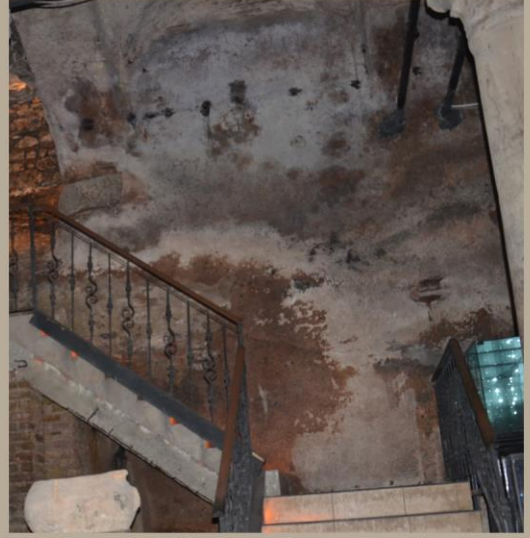
Şekil 4.8.B. Giriş Alanı Duvar Bozulmaları (Yıldırım Arşivi)
