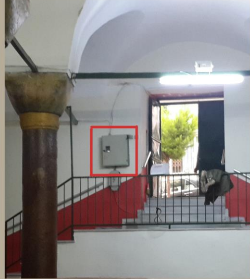
Şekil 4.52.C. Elektrik Panosu (Yıldırım Arşivi)
