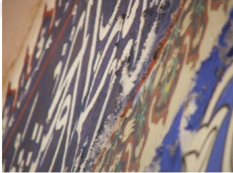
Fotoğraf 7. Hidayet Camii Restorasyon Sonrası Nemden Kaynaklı Boya Kabarmaları
