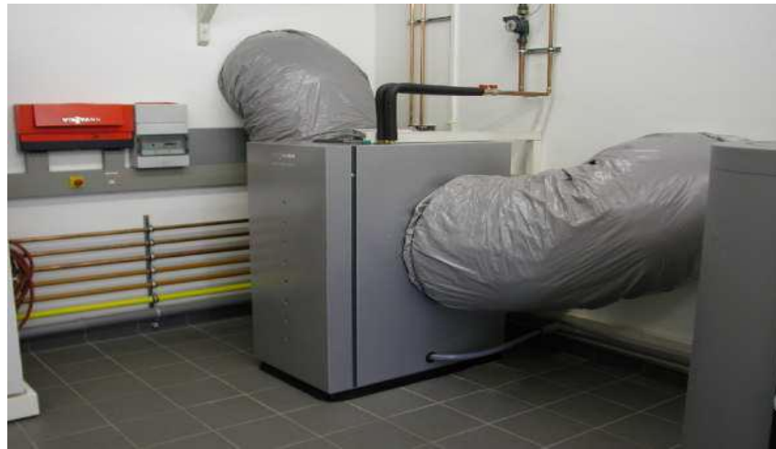
Şekil 11: İç mekanda hava kaynaklı ısı pompası
