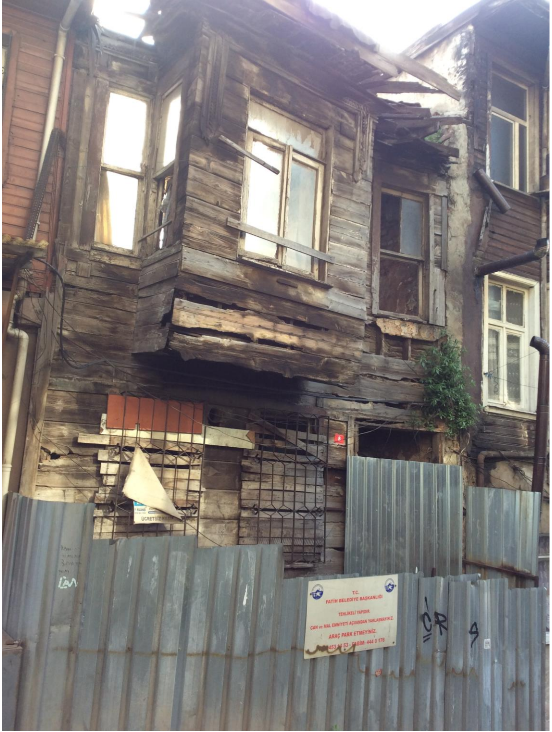
Şekil. Çökme tehlikesi altındaki yapılar.
