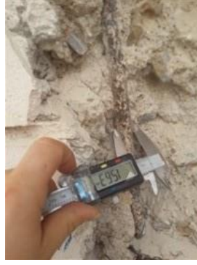
SZ04 kolonu korozyon oranı %5
