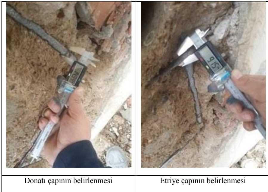
Şekil4. 9: Tahribatlı Donatı tespiti (b)
