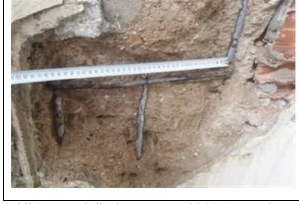
Şekil 4. 10: Tahribatlı Donatı tespiti (c) (Kanca detayı)
