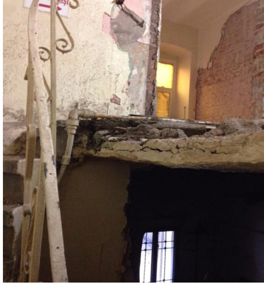
Şekil 5.2 Döşemelerde Meydana Gelen Bozulmalar
