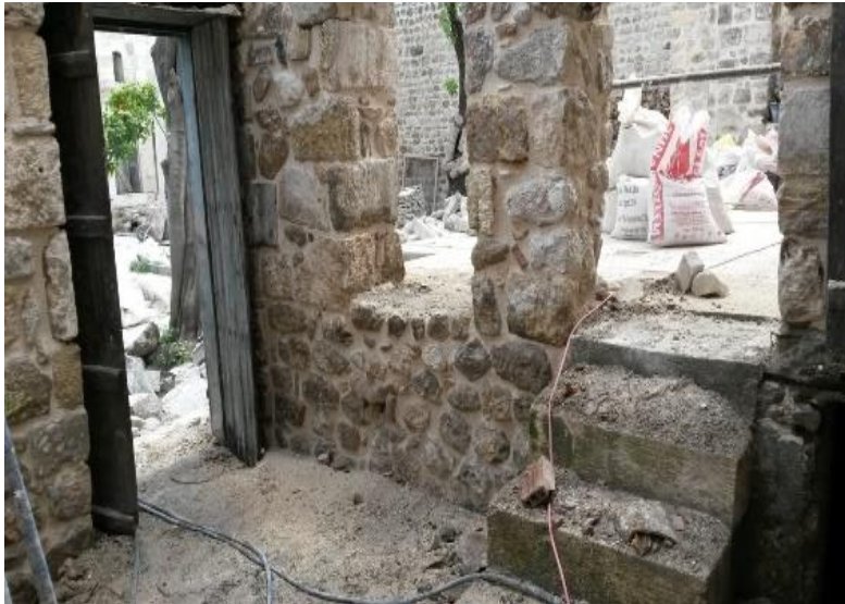
Şekil 91. Mutfak mekanında yok edilen merdiven
