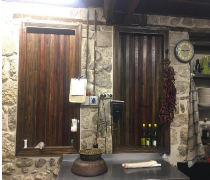
Şekil 89. Mutfak mekanında işlevsiz hale getirilen pencereler
