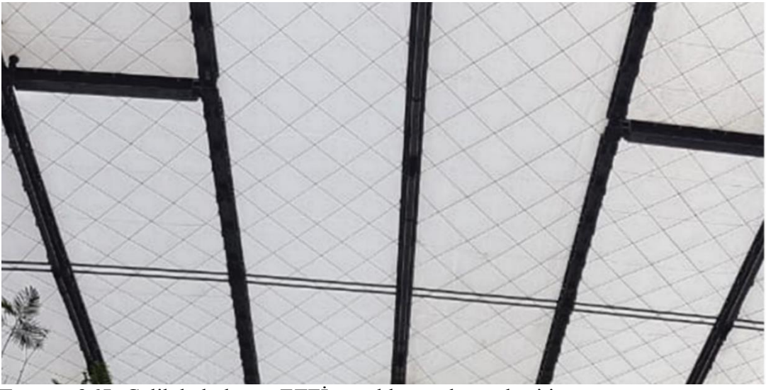
Fotoğraf 65: Çelik halatlar ve ETFİ yastıklar, çadır cephesi iç görünüş Yazarın arşivinden alınmıştır
