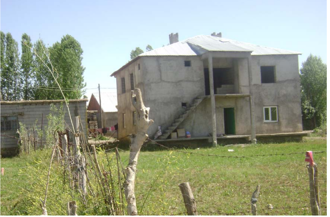
Fotoğraf-19: Beldede henüz tamamlanmamış, inşaatı süren evlerden biri. Para buldukça evlerini bitirmeye çalışan hane bireyleri, yandaki gecekonduda otururken uzun yıllar sürecektir olan evlerinde oturmanın hayallerini kurmaktadır.
