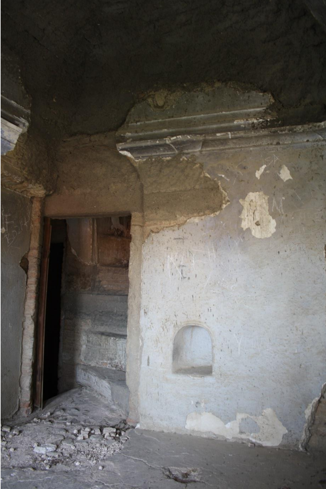
Fotoğraf-209: Koçarlı İbrahim Ağa Kulesi 2. kat yazlık oda güney duvarı
