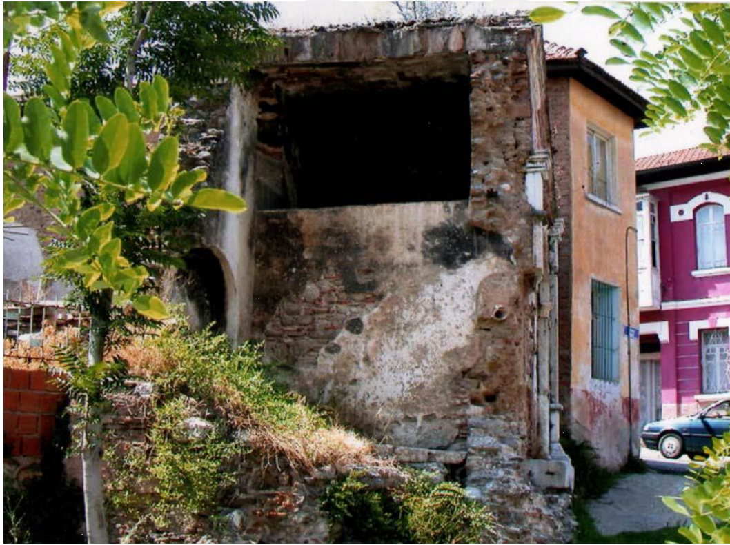
Fotoğraf-164: Ümmügülsüm (Ümmühan) Hanım Çeşme ve Sebil restorasyon öncesi (M. YILMAZ'dan)
