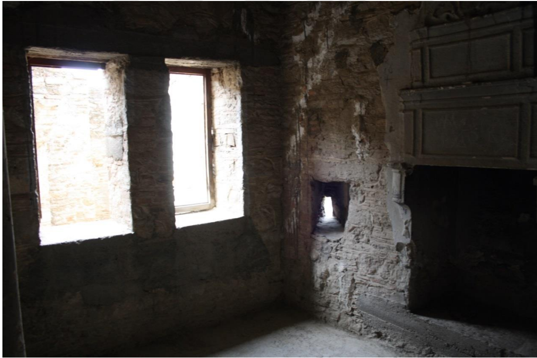
Fotoğraf-208: Koçarlı İbrahim Ağa Kulesi 2. kat kışlık oda kuzey ve doğu duvarı
