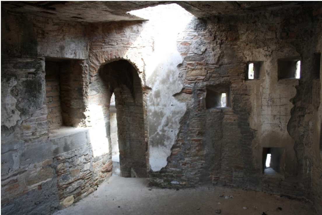
Fotoğraf-219: Koçarlı İbrahim Ağa Kulesi 3. kat yazlık oda güney duvarı
