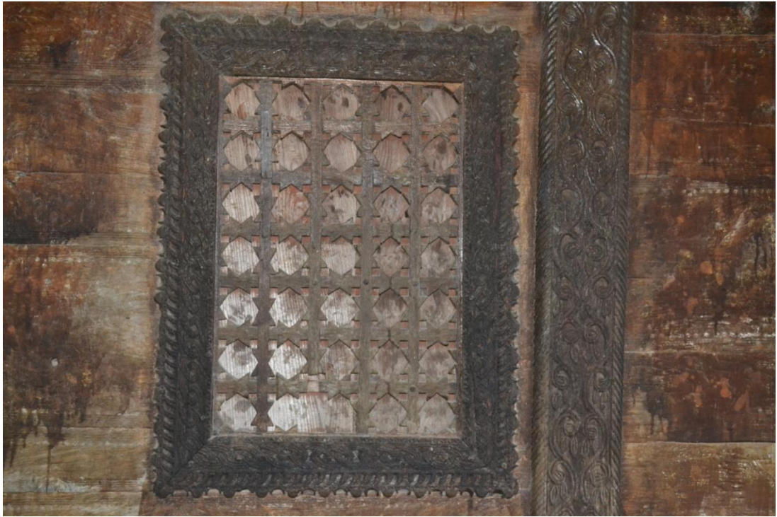
Fotoğraf 182: Dereyurt Köyü Merkez Eski Camii Son Cemaat Kısımındaki Ahşap Sürgülü Pencereden Detay
