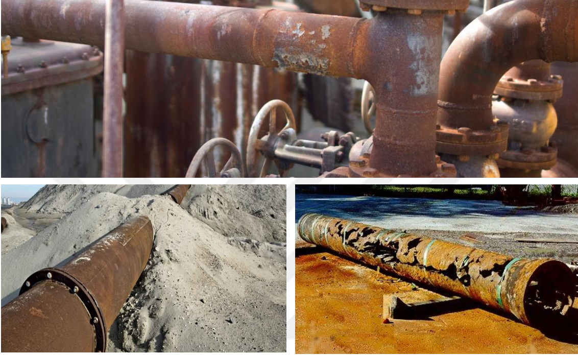
Şekil 1.2 CPS Desalator de gözlemlenebilir korozyon durumun örnekleri .
