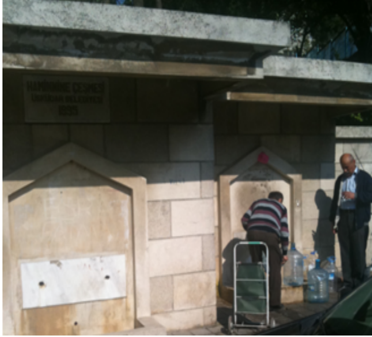
Şekil 3.9. İstanbul ili, Ümraniye ilçesinde bulunan kaynak suyu çeşmesi.
