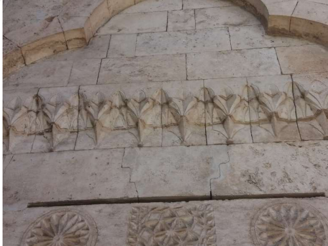
Şekil 3.16 Hüsrev Paşa Camisi ikinci kabartma
