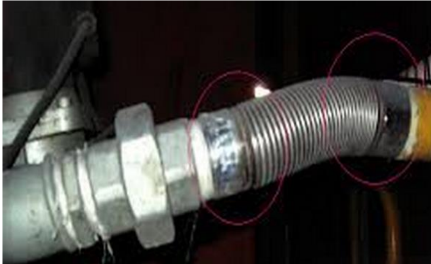
Resim 1.2. Galvanik korozyona uğramış çelik gaz borusu (URL-2 2015)
