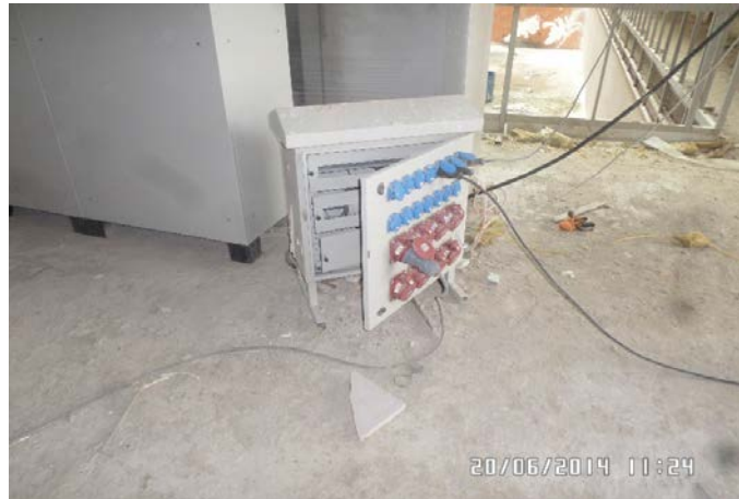
Resim 16: Elektrik panosunun uygun olmayan kullanım şekli
