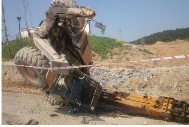
Resim 32: İstanbul 3.köprü inşaatında ölümle sonuçlanan ekipman devrilmesi
