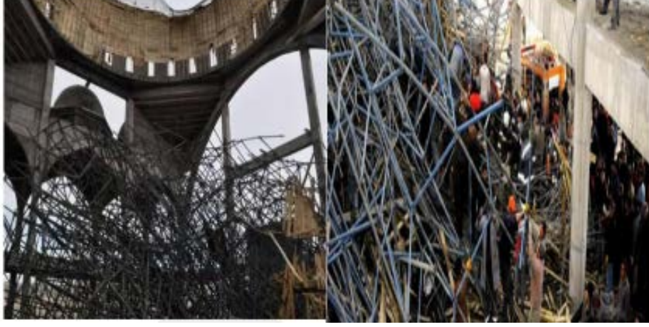
Resim 15: Nevşehir- Acıgöl Cami inşaatı- kubbe beton kalıbı ve kalıp iskelesinin çökmesi (17.12.2011)
