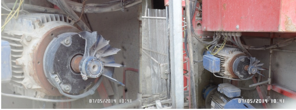
Resim 34: Dış cephe asansörü motor tertibatı
