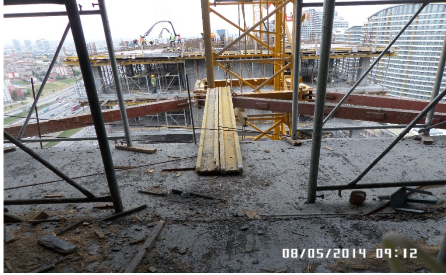
Resim 4: Bağcılardaki pilot şantiyede çekilmiş binadan kule vinçe uygun olmayan geçiş örneği
