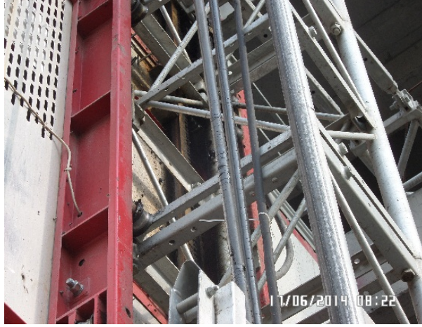
Resim 33: Asansör halatının hasarlı olması
