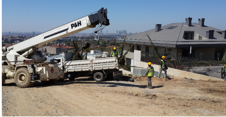
Resim 31: Kaldırma ekipmanının yanlış kullanımı
