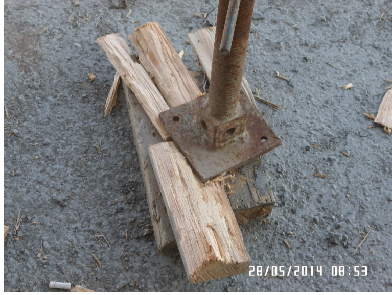
Resim 11: Kalıp iskelelerinde seviyeyi sağlamak amacıyla yapılan yanlış uygulama
