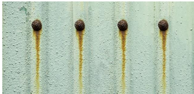
Şekil 1.6. Galvanik korozyona uğrayan demir cıvatalar (URL-6 2017)
