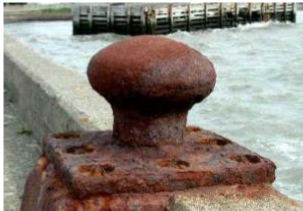
Şekil 1.1. Homojen korozyona uğramış metal (URL-1 2017)
