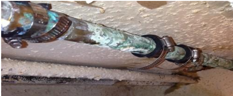
Şekil 1.6. Çukurcuk korozyonuna uğramış metal yüzeyi (URL-6 2018)
