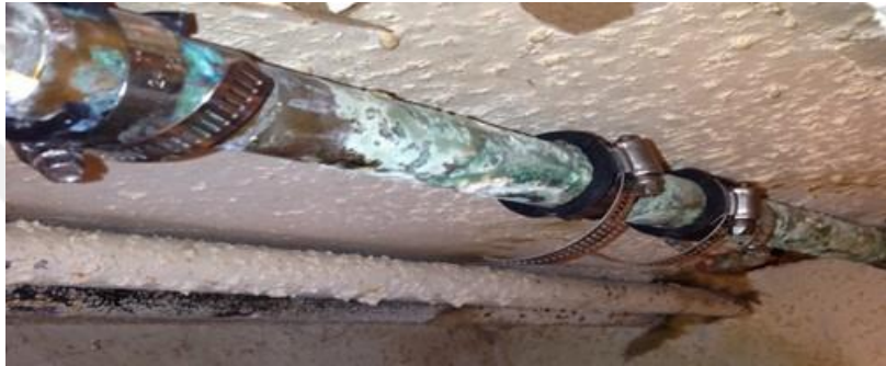
Şekil 1.5. Erozyon korozyonuna uğramış su borusu (URL-5 2018)
