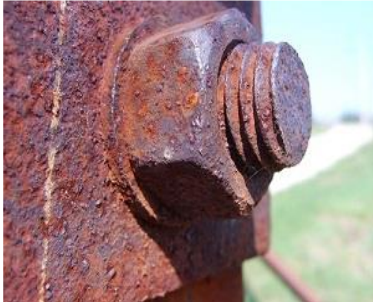
Şekil 1.1. Homojen korozyona uğramış somon+ vida (URL-2, 2009)
