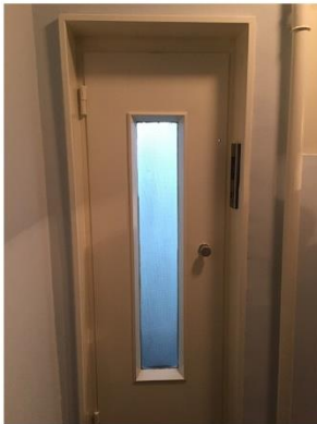
G: Elevator Door
