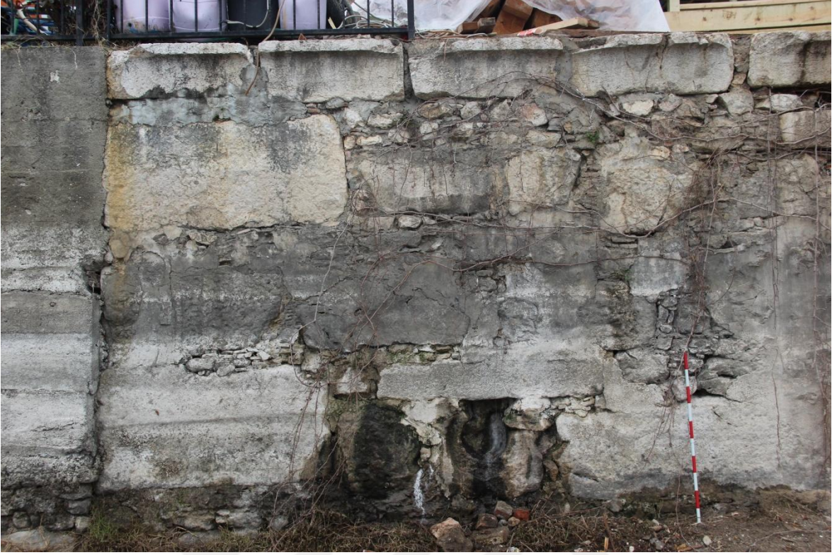
Resim 34:Doğu Sur 7 numaralı duvar
