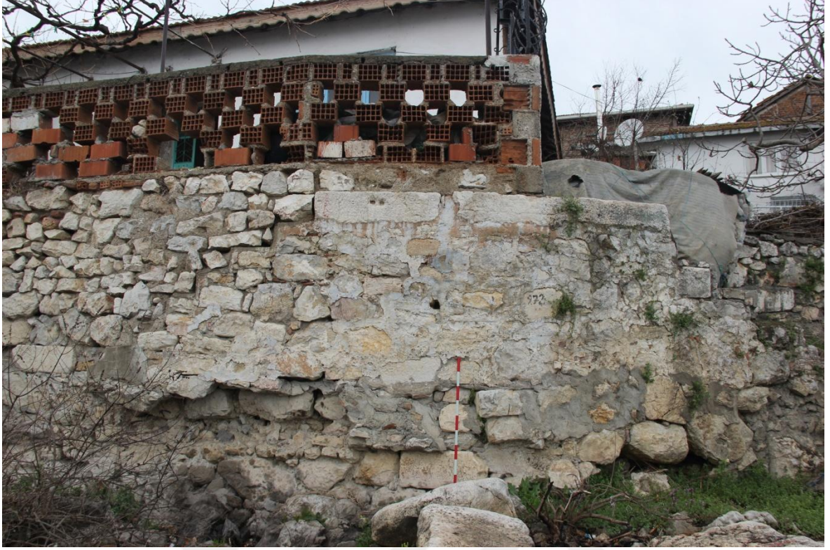
Resim 30: Doğu Sur "4" numaralı duvar
