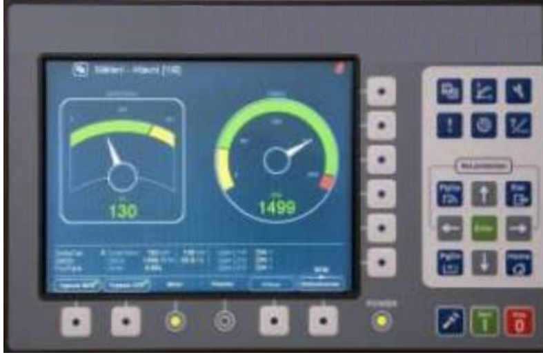
Şekil 3.5 : Kojenerasyon sistemi görüntü ünitesi
