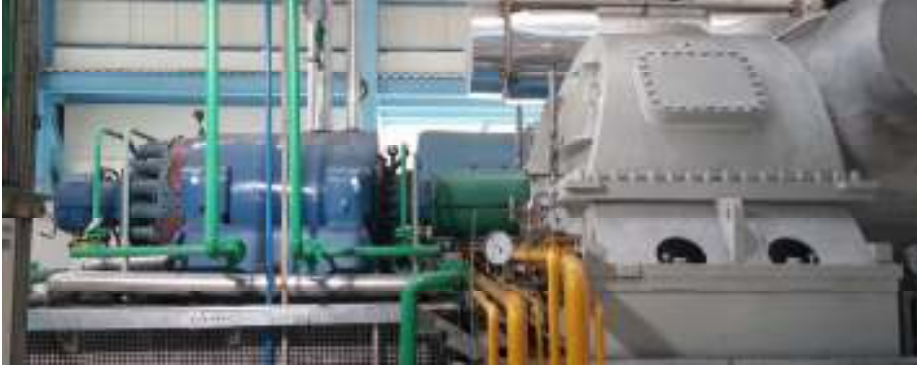
Şekil 5.8 Türbin tahrikli kazan besi suyu pompası
