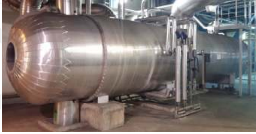
Şekil 5.6 Düşük basınç ısıtıcı
