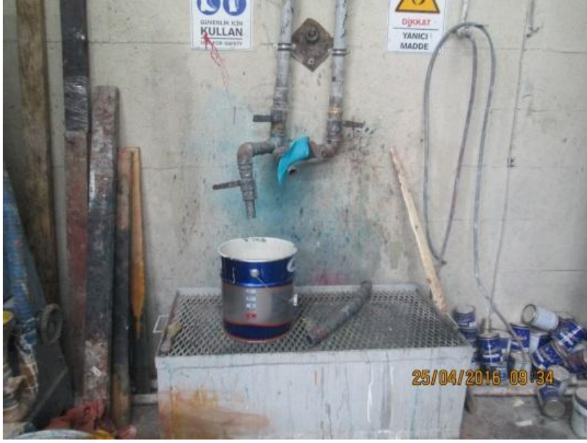
Şekil 7.8 : Zemin kat tolüen ve white spirite elleçleme tesisatı.
