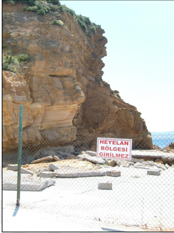
Fotoğraf 29: Çayağzı mevkiinde yüksek kıyılardaki heyelanlı bölge
