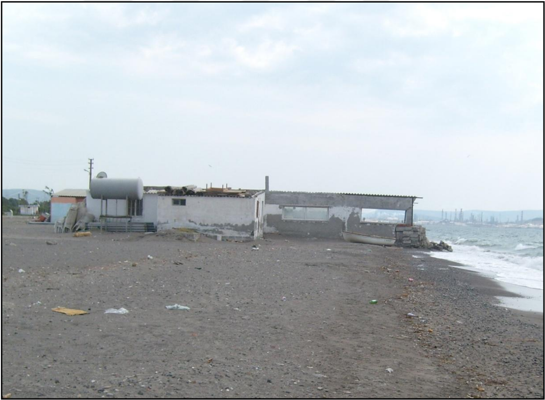
Fotoğraf 34: Güzelhisar deltası kıyılarında oluşan kıyı erozyonu sonucu temeli su altında kalan baraka
