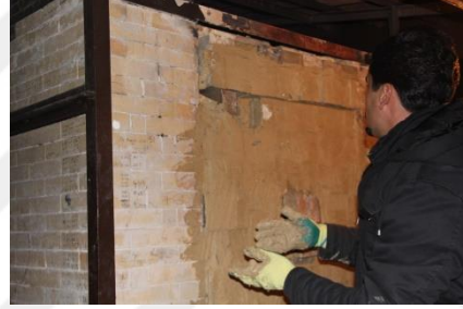
Resim 172: Tuz Fırınının Isı Kaybı Yaşanmaması ve İçerisindeki Oluşacak Gazın Dışarı Sızmasını Engellemek İçin Tuğlaların Sıvanması
