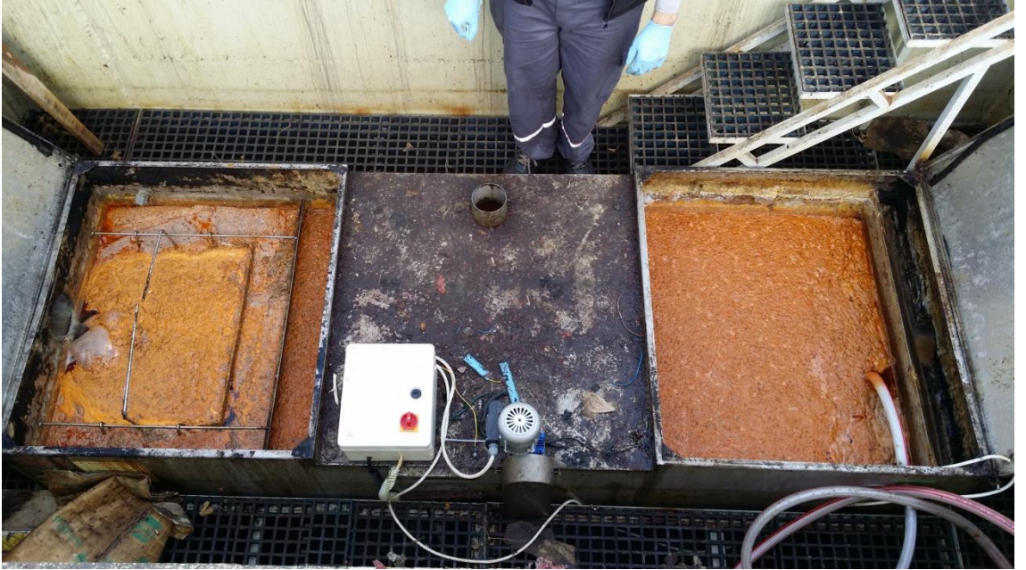
Şekil 4.21. 1 nolu işletmede bulunan yağ tutucu sistemi
