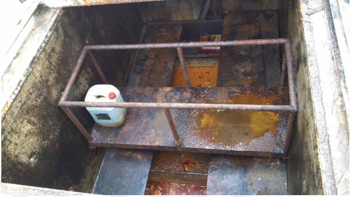
Şekil 4.22. 2 nolu işletmede bulunan yağ tutucu sistemi
