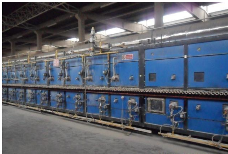
Şekil 8.2 Seramik fırını ve hidrojen zenginleştirme sistemi
