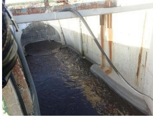
Resim 3.2 Atıksu Tesise Giriş Numune Alım Noktası (1.Nokta)
