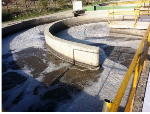
Resim 3.6 Biyolojik Arıtma Sonrası Numune Alım Noktası (3. Nokta)
