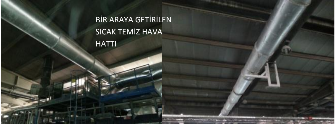
Resim 6.6. Temiz sıcak hava hatlarının birleşmesiyle oluşan boru hattı
