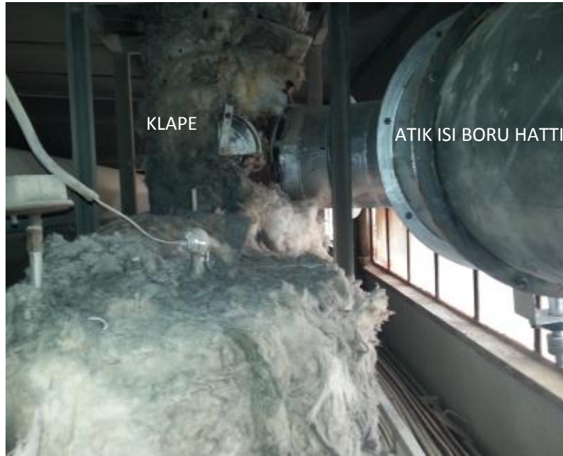
Resim 6.3. Temiz sıcak hava bacasından alınan havanın ilk boru hattı
