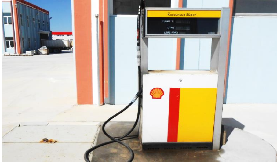
Resim 3. 47. Mermer işleme tesisi akaryakıt pompası
