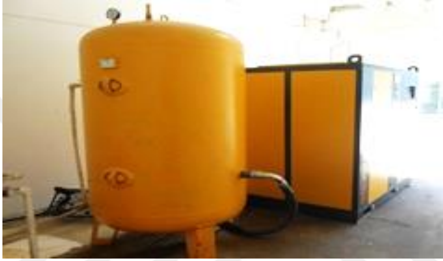
Resim 3. 45. Mermer işleme tesisi kompresör ünitesi
