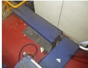
Resim 5.15. Cpt Kablo Kanalı
