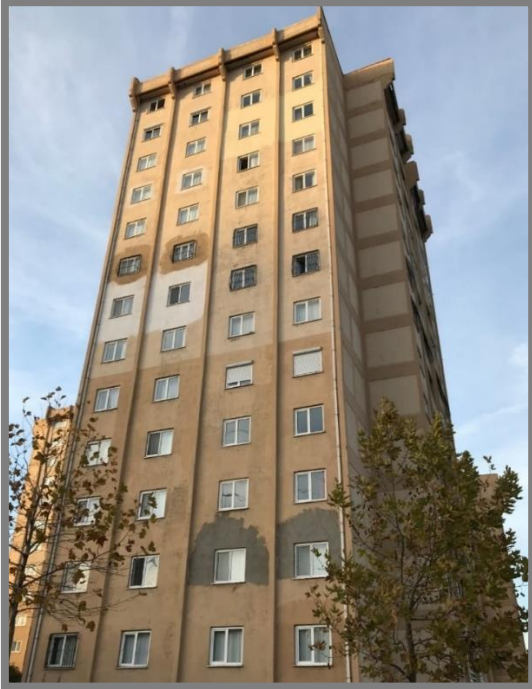
Resim 5.7. Uzundere TOKİ rutubetten kaynaklı cephe tadilatları (02.12.2017)
