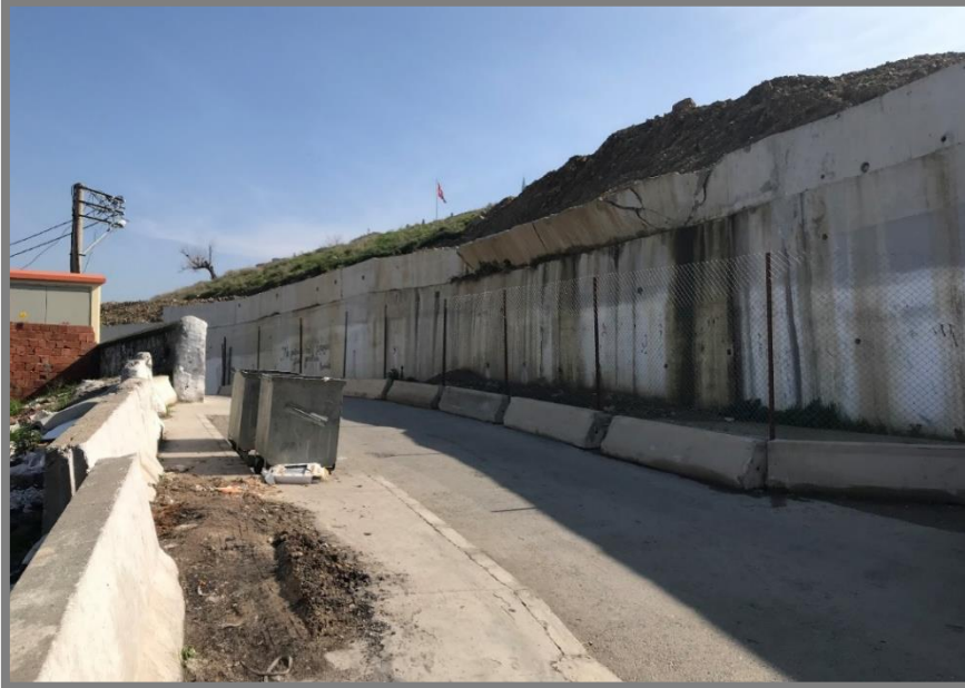
Resim 5.2. Kadifekale'de kentsel dönüşümden sonra heyelandan etkilenen istinat duvarı (18.02.2018)
