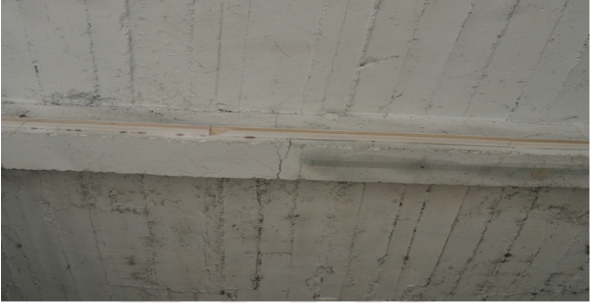
Resim 6.3. Yapıdaki çatlamış kiriş
