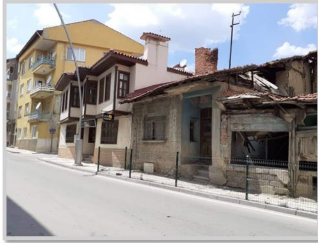
Resim 8.2.2. Terk edilmiş riskli yapı görünümü
