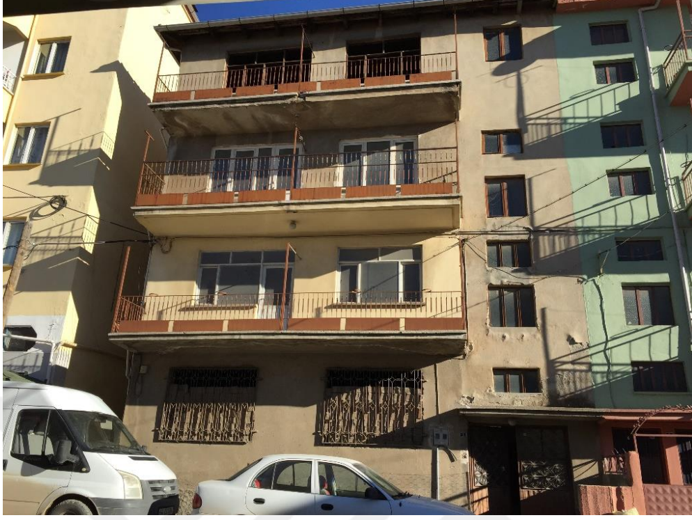
Şekil 4.3. Riskli yapının fotoğrafı
