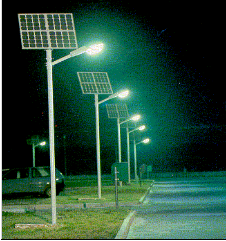
Şekil 1.22. Güneş pilleri ile sokak aydınlatması
