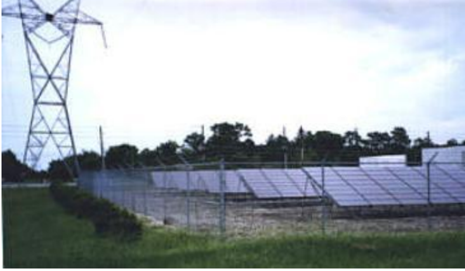
Şekil 1.31. Şebekeye elektrik veren bir güneş pili santrali (URL-13, 2011).
