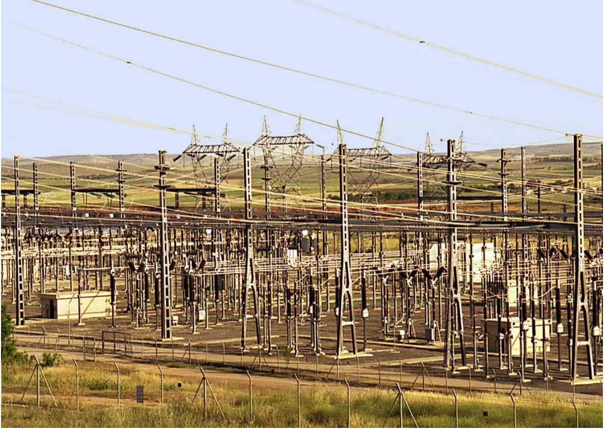
Şekil 2.2 Atatürk HES 380 kV açık şalt sahası
