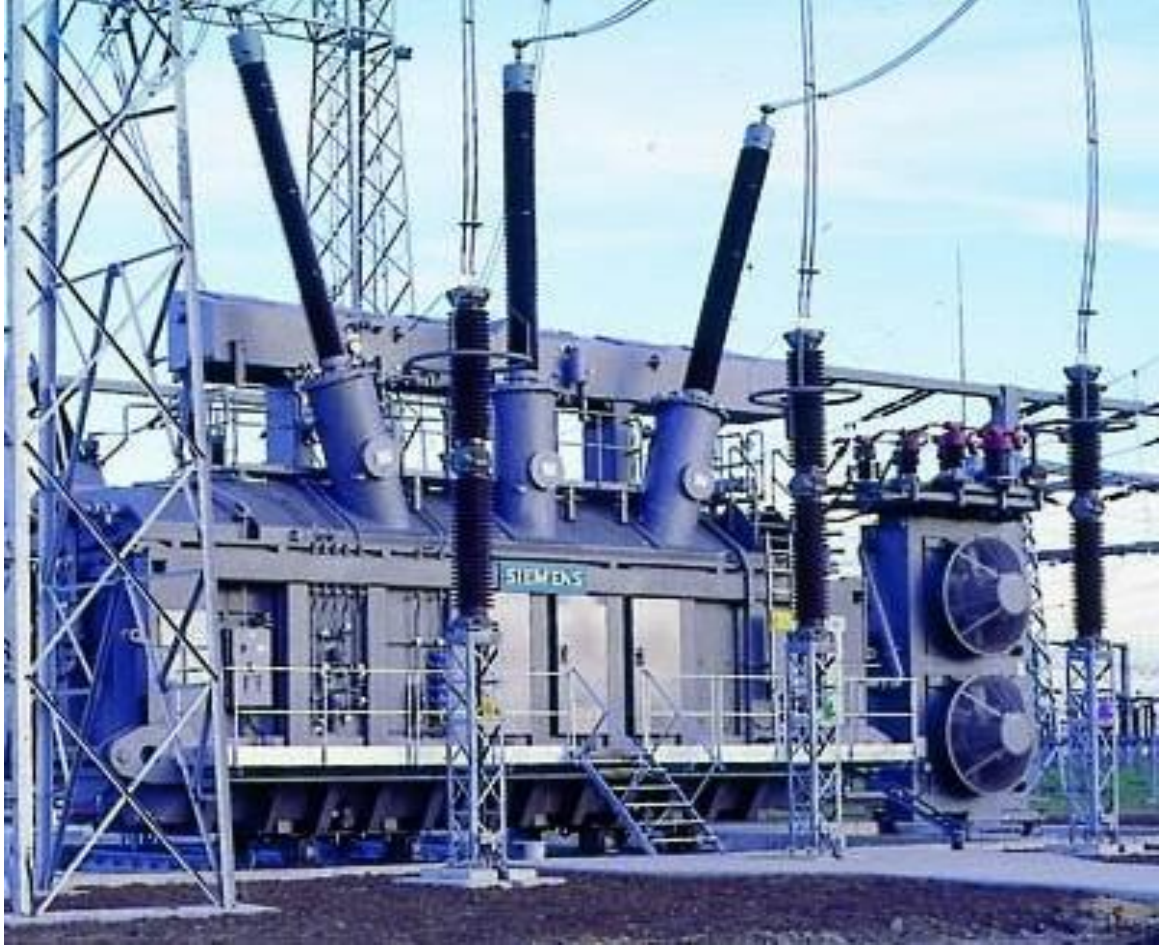
Şekil 2.4 Batman 2 İTM 380 kV açık şalt sahası 380/34,5 kV indirici trafo
