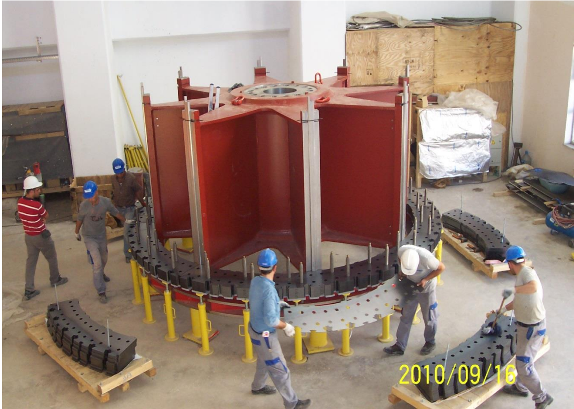
Şekil 3.3 Alkumru HES’de 97 MVA gücündeki bir senkron generatörün rotor karkası ve sac montajı
