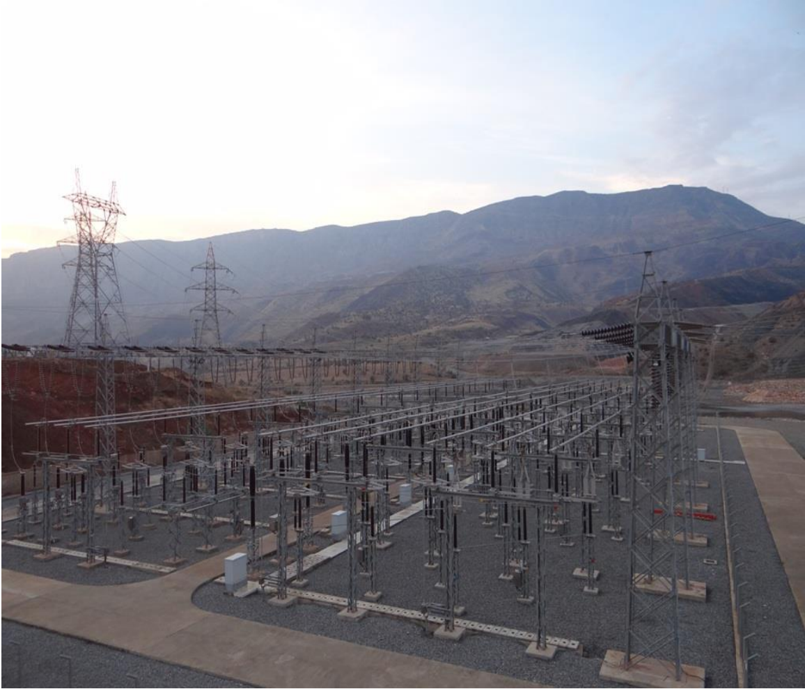
Şekil 2.3 Alkumru HES 154 kV açık şalt sahası
