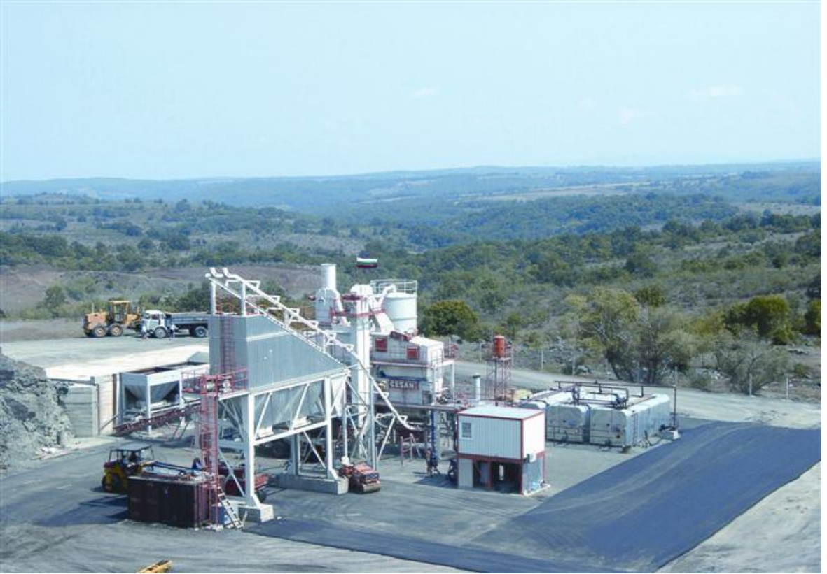
Şekil 1.1. Bir asfalt geri dönüşüm santrali (URL-1).
