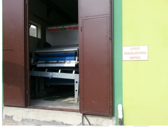
Şekil 4.10. Çamur Susuzlaştırma Ünitesi
