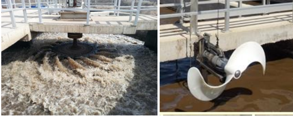
Şekil 4.8. Yüzeysel aeratörler ve muz tipi karıştırıcılar
