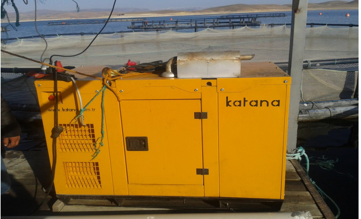
Şekil 3.14. Hasan Ali Baysal Alabalık Yetiştiricilik Tesisine Ait Jeneratör – ÇEMİŞGEZEK/TUNCELİ
