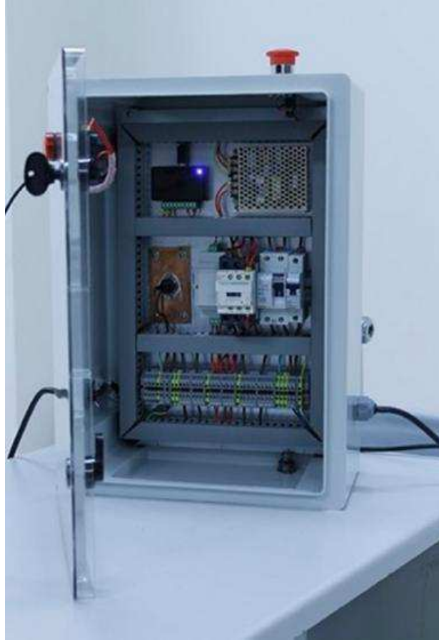
Şekil 2.10. Güç kontrol ünitesi (Erkan, 2012).
