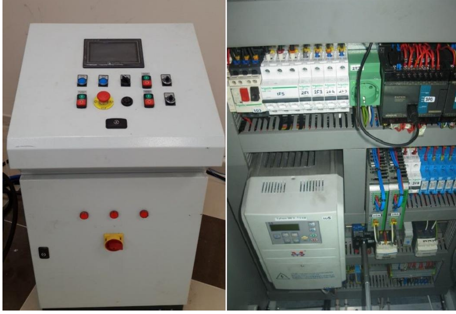
Resim 2.3. Elektrik panosu ve kontrol ünitesi
