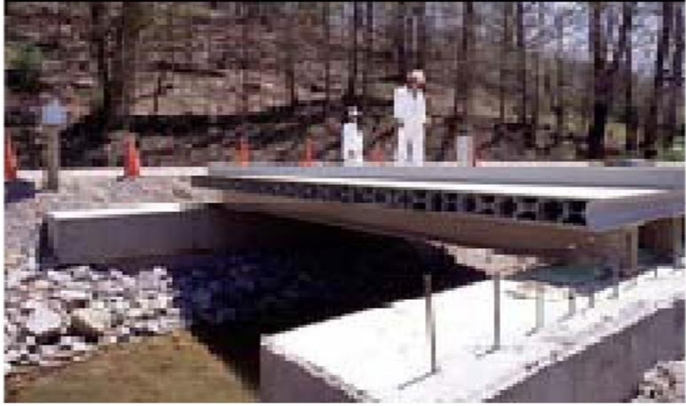
Resim2.5. Kompozit malzemelerin köprü kirişlerinde kullanımı
