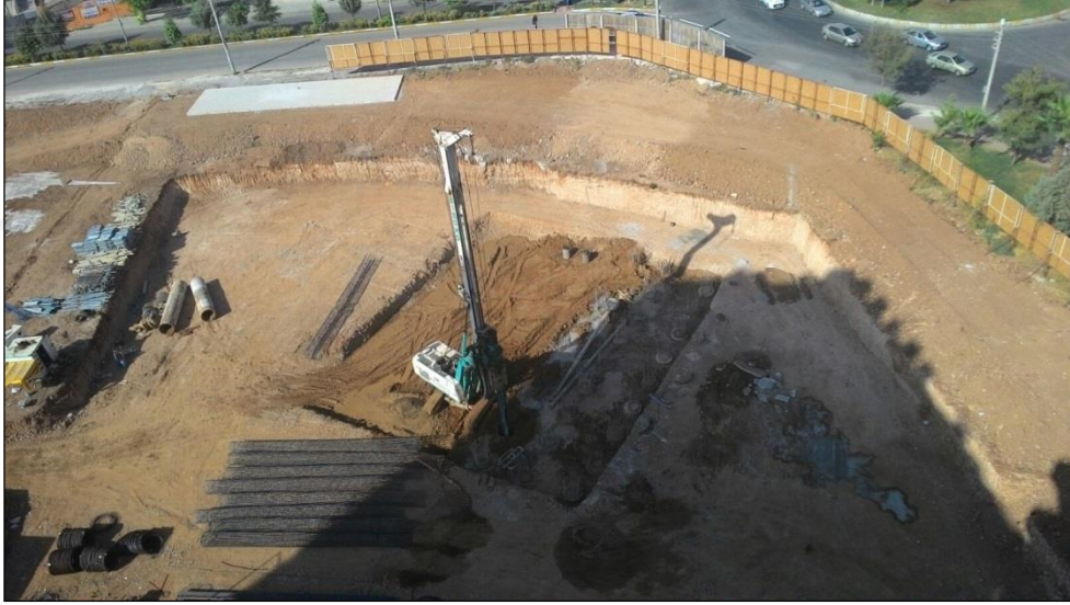
Şekil 2.1 Seçilen 25 katlı binanın fore kazık saha çalışmasından görünümü.
