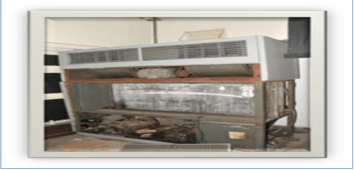
Şekil 2.11. Amerikan (Westinghouse Marka) fan sistemi (Akdeniz Belediye arşivinden)
