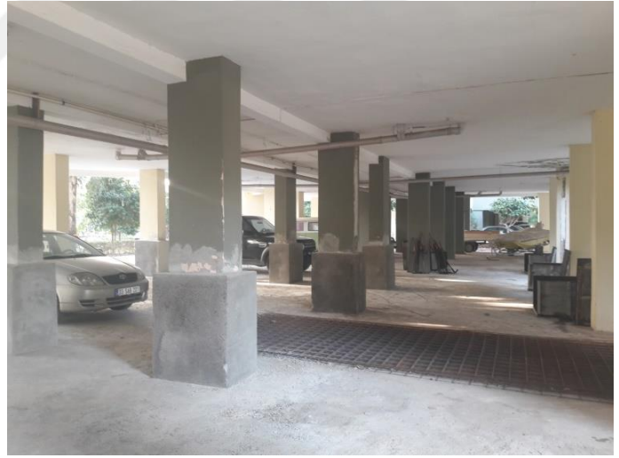
Şekil 3.5.4: Tahrip olan zemin kat kolonları ve yapılan güçlendirme (Soli1).
