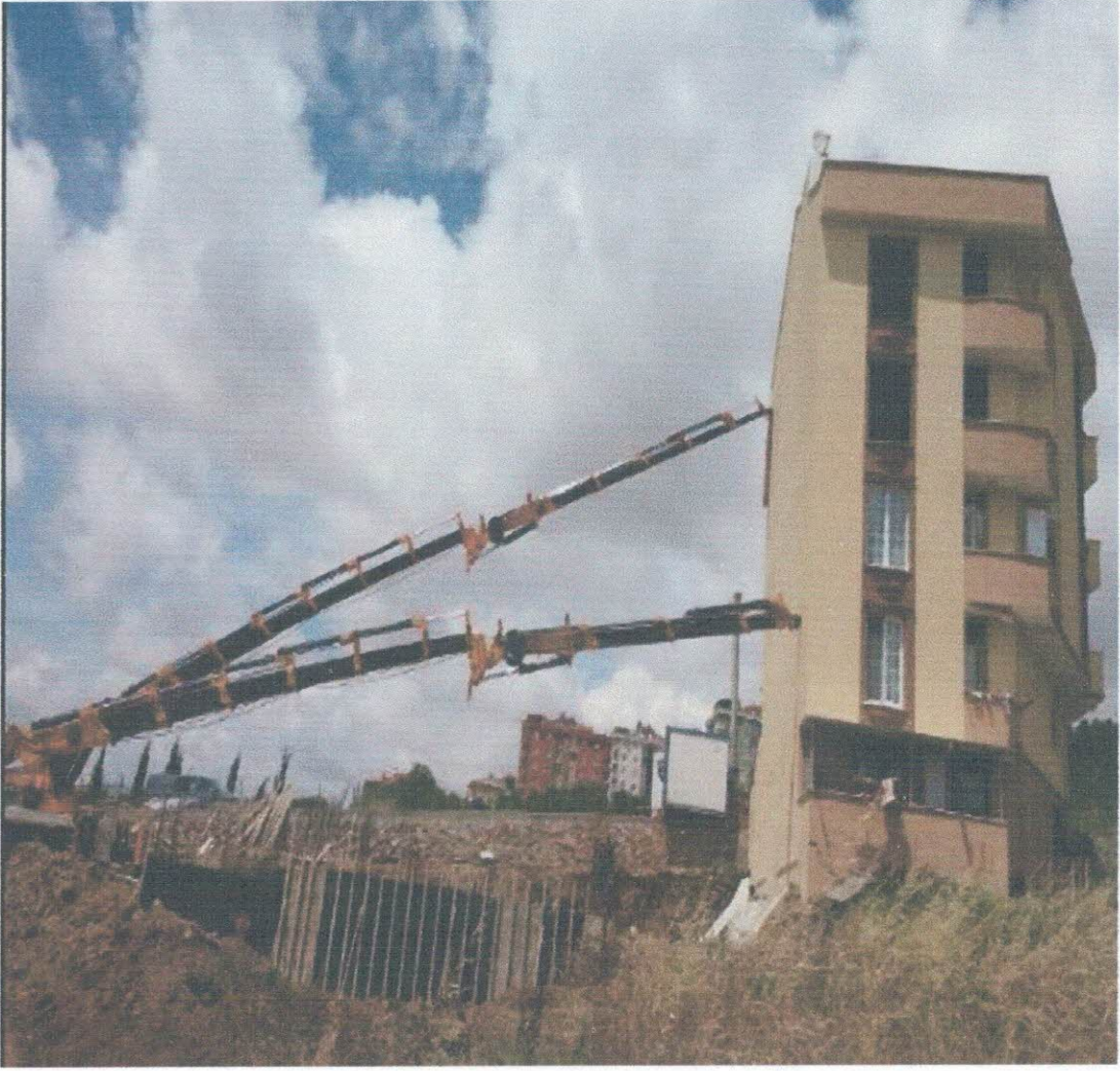
EK2. Temel kazısı sonrası devrilme tehlikesi geiren bina
